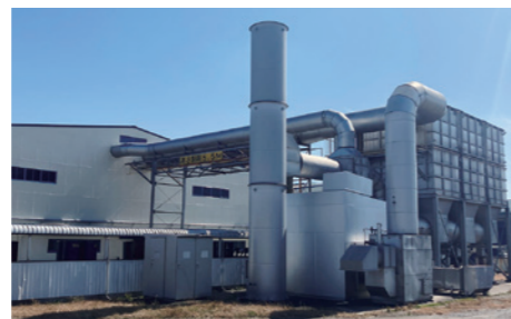
排ガス浄化装置
